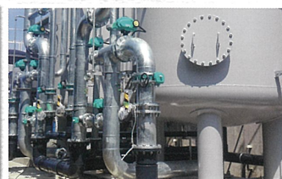
特殊ろ材ろ過塔
