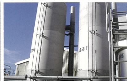
オゾン処理塔
