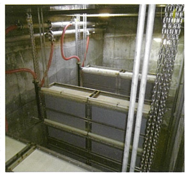
膜分離槽内部
