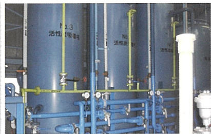
活性炭吸着システム
