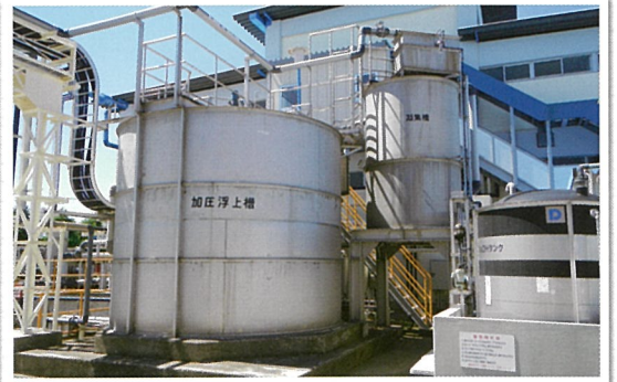
加圧浮上槽外観
