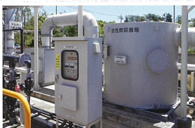
■ 脱臭装置外観
