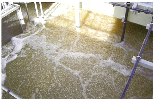
担体槽 微生物を保持した担体が槽内を流動している
