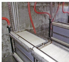
膜分離槽内写真
