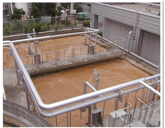
活性汚泥処理システム 曝気槽外観
